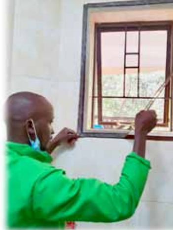
Une toile anti-moustiques est fixée aux fenêtres
